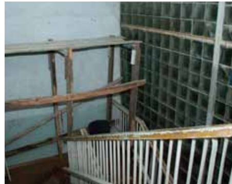
Das Treppenhaus ist Renovierungsbedürftig
